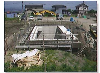
汚水処理施設
